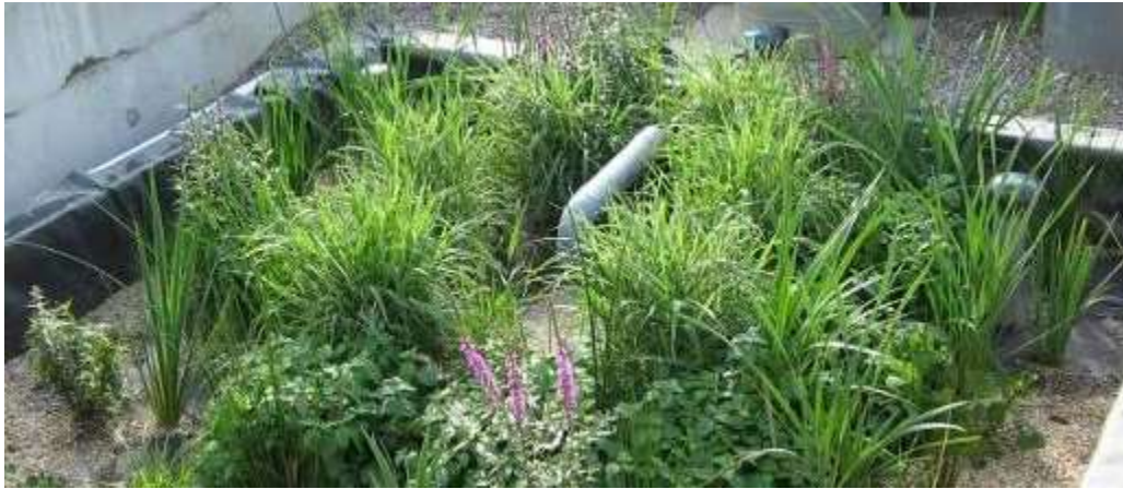
Illustration 14. Une prise de vue du filtre vertical du dispositif Phytostation 6 EH installé au CSTB pour l'essai des performances 2012-2013, sept semaines après l'installation. A noter que le développement des végétaux n'est jamais identique dans toutes les installations en raison de différences en nature et production d'effluents et en conditions climatiques (ex. précipitation, température).
